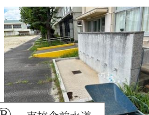
㉓ 東校舎前水道
